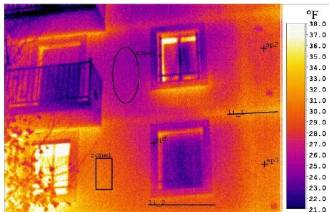
Figure IV-11. Image thermique d'une façade d'immeuble permettant de localiser les pertes thermiques
