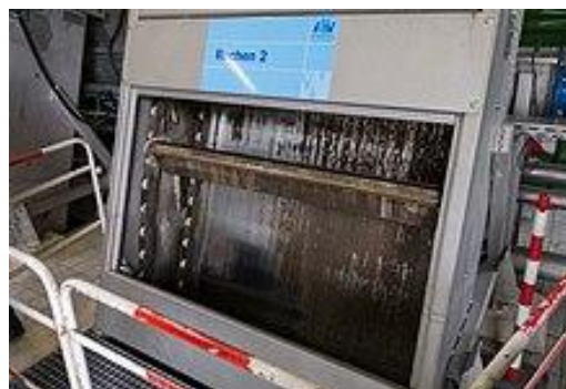
Fig .V.2.Dégrillage et tamisage des eaux usées
